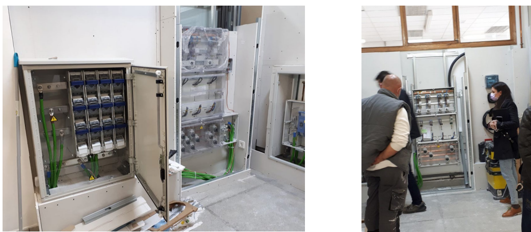
Fig. Ejecución de nueva maqueta actualizada Electrotecnia.
